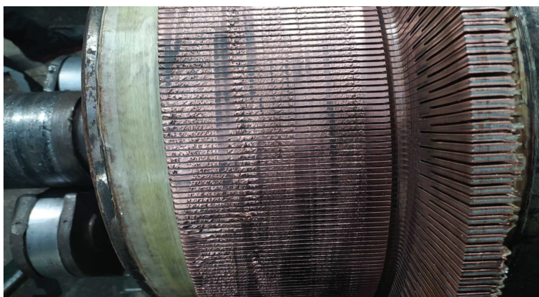
Рис. 3. Пошкодження колектора, що викликані утворенням електричної дуги та натисканням щіток [3]
