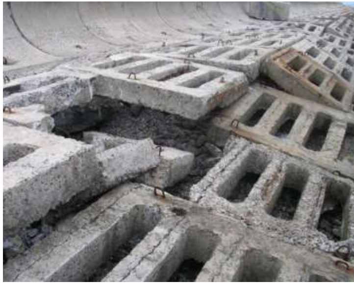
Рис. 1. Современное техническое состояние берегозащитных сооружений пассивного типа в черте г. Одессы
