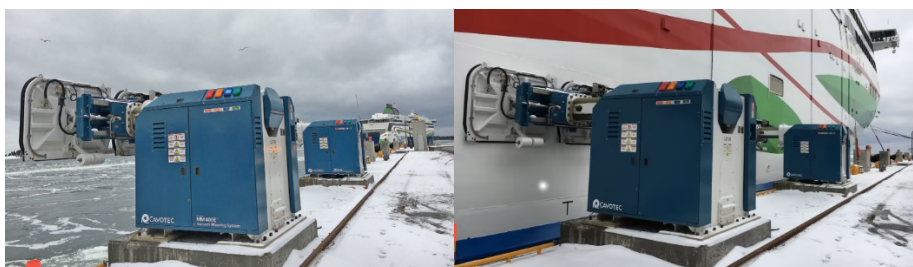
Рис. 1. MoorMaster™ система автоматизованого швартування [6]
